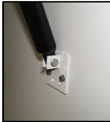
Beschlag auf den Prozessor muss laut o.a. montiert werden
